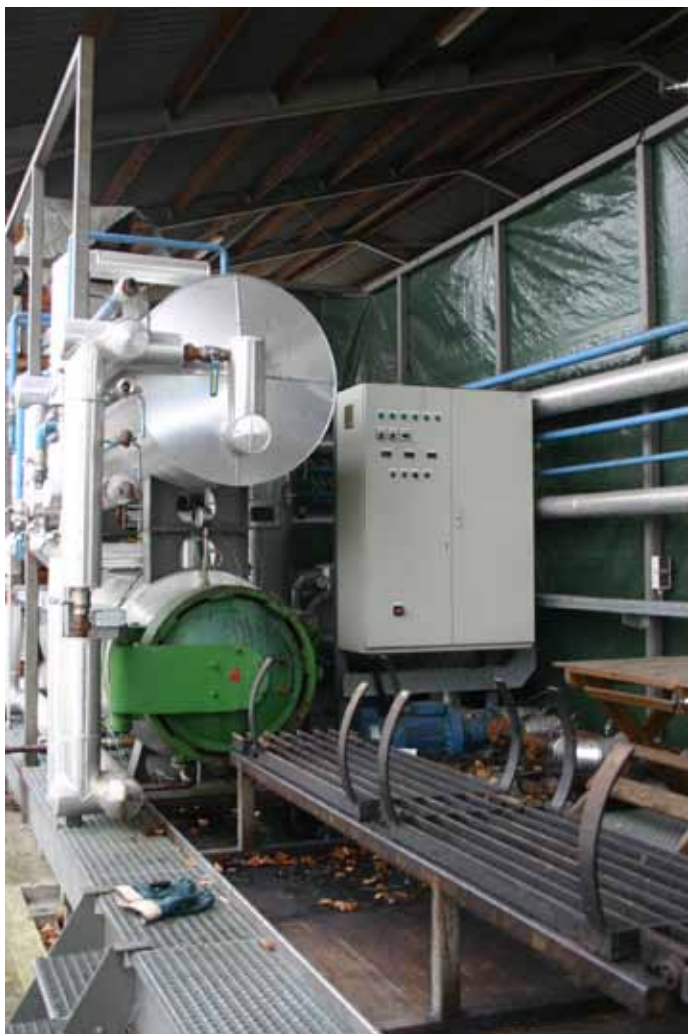
De proefinstallatie voor NobelWood
