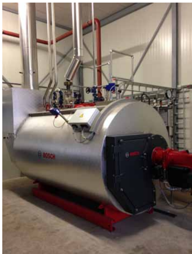
De stoomketel van de nieuwe installatie
